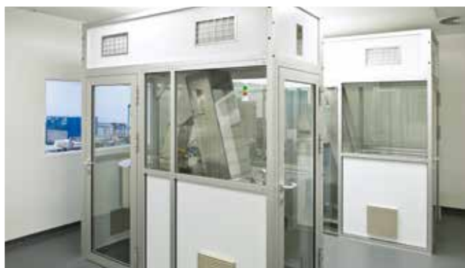
Reinraum Einhausung einer Maschine in der Pharmazie
